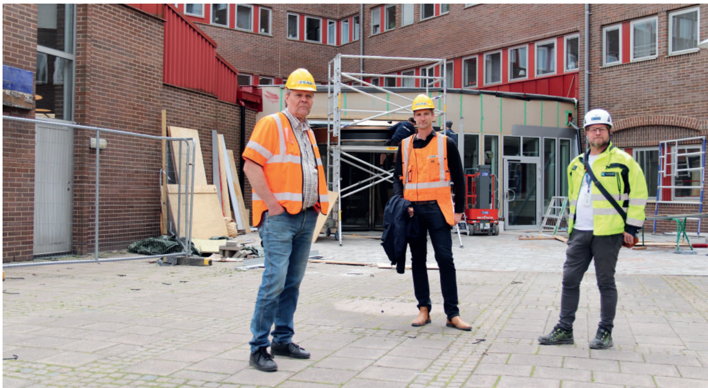
Trollhättans Stads fastighetschef Roger Karlsson och projektledare Martin Linnér tillsammans med Kraftstadens Tobias Björk utanför stadshusets entré, som kommer att bli både rymligare, ljusare och mer tillgänglig än tidigare.
